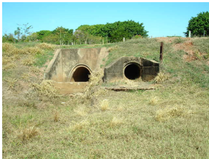
Saída das águas pluviais do lago artificial (piscinão)
