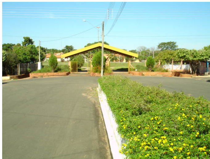
Duas canaletas superficiais (lado esquerdo e direito) de captação de águas pluviais (sub-bacia F)
