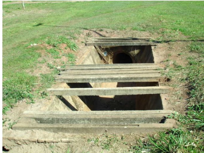
Caixa de passagem que faz ligação com a tubulação de saída do lago artificial (piscinão) – sub-bacia G
