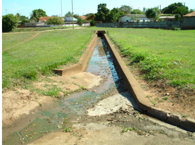
Canaleta superficial de captação de águas pluviais (sub-bacia G)
